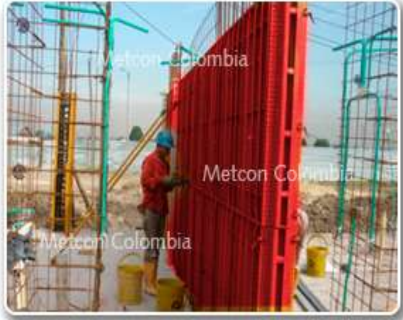
APLOME DE MURO Y TAPA MUROS
